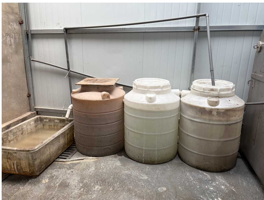
废水处理设施（初沉+混凝沉淀）
